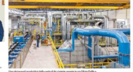
Una dei reparti produttivi della sede di Acciaierie Veneta in via S. Felice Padova
